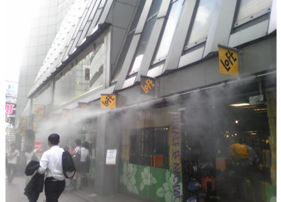
●店舗入り口に設置した「涼霧システム®」
